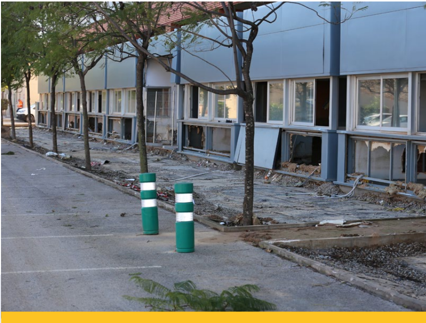
Complejo de edificios de València Sud: Incluye el edificio principal de oficinas, el edificio de operaciones, el de instalaciones fijas, el comedor laboral, el servicio médico y las secciones sindicales, todos ellos severamente dañados por el agua. Los equipamientos interiores y parte de la infraestructura resultaron devastados. En el caso del edificio principal, será necesario reconstruir por completo la planta baja.
