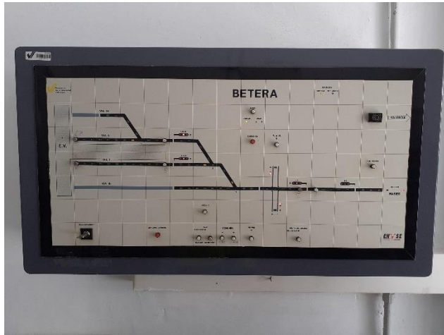
Cuadro de mando enclavamiento de Bétera L1 metro
