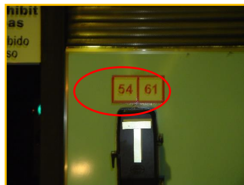
Numeración armarios de seguridad del túnel
