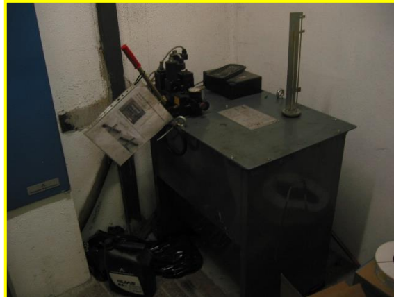
Bomba hidráulica manual para manejo del ascensor
