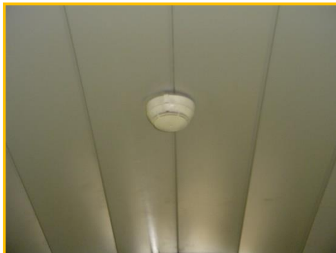
Elemento detector fijado en techo
