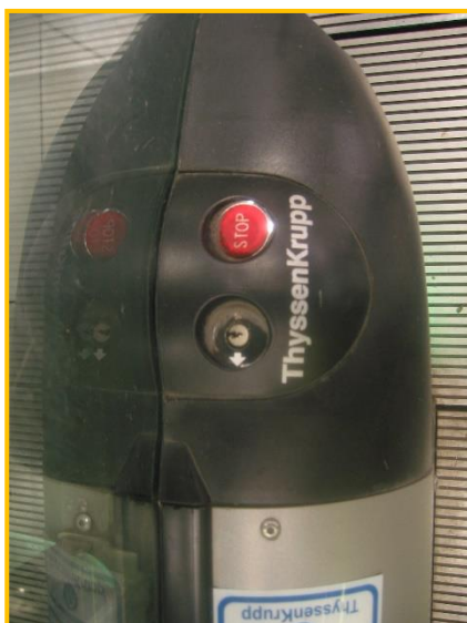
Rearme manual de la escalera y Pulsador de Stop para incidencias.
