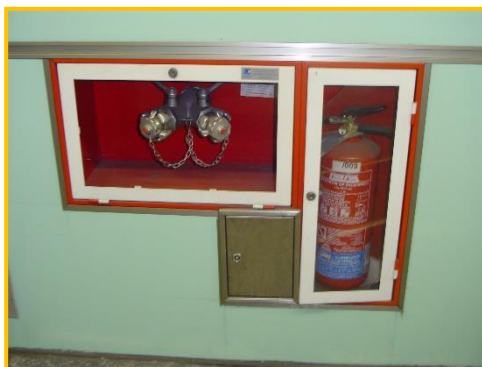
Tomas siamesas y extintor
