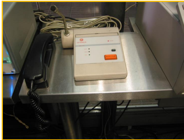
Equipo de megafonía local de una estación
