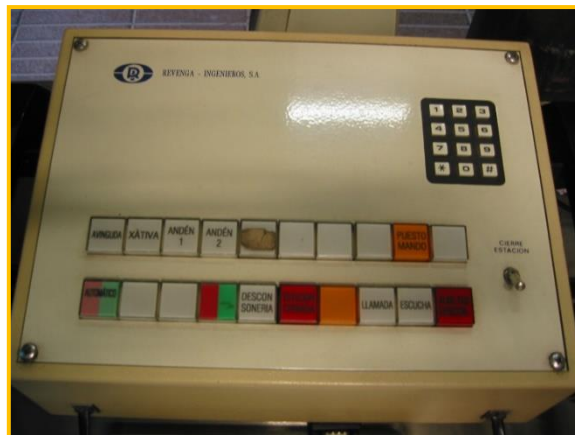
Consola que integra el teléfono selectivo y el teléfono de extensiones.
