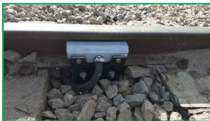
Imagen 4: Equipo exterior :Contador de ejes
