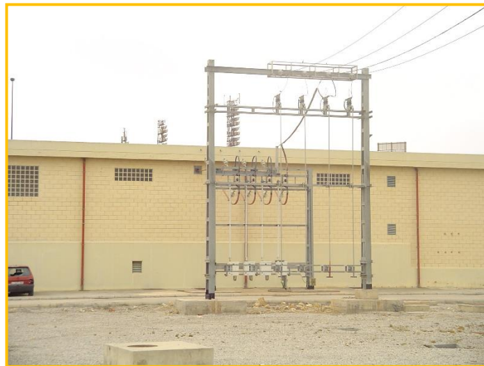
Subestación de talleres Machado, pórtico de salida
