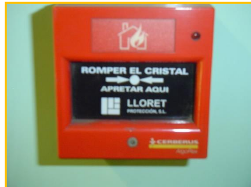
Pulsador de Alarma de incendios
